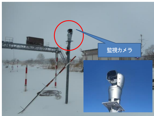
写真-29 監視カメラ設置状況
