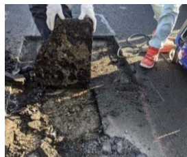
写真-2 床版の 土砂化の例 2
