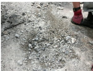
写真-1 床版の 土砂化の例 1
