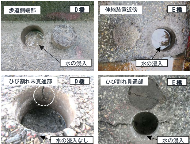
写真-8 コア開孔部における浸水状況
