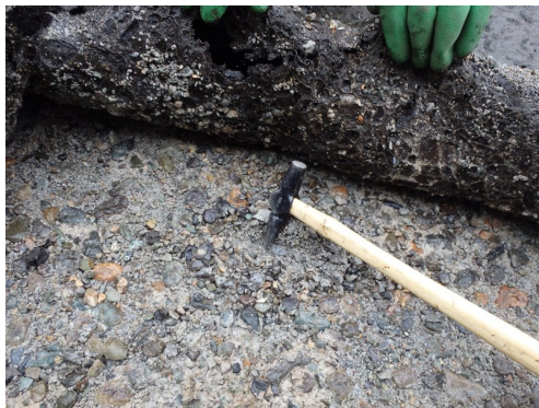
図-5 防水層下の土砂化の事例 (T橋)
