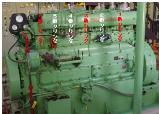
写真-7 S排水機場 1号原動機(2号機も同型)
