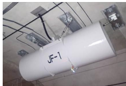
写真-1 ジェットファンの設置状況の例
