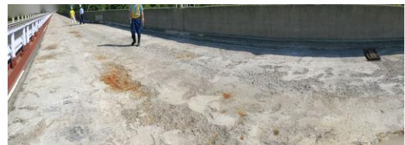
写真-1 舗装開削後の土砂化が進行した事例
