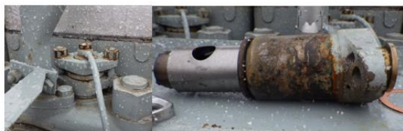
写真-9 始動弁 (左は外す前のシリンダヘッド)
