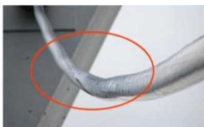
写真-10 損傷したケーブルのよれ
