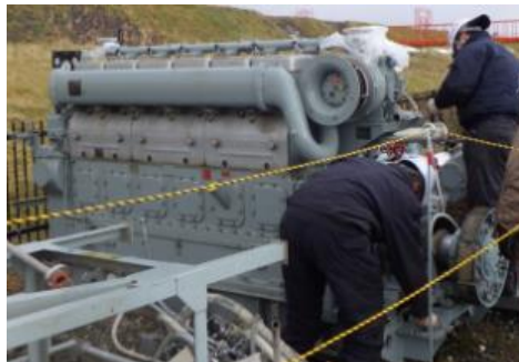
写真-6 B排水機場 1号原動機
