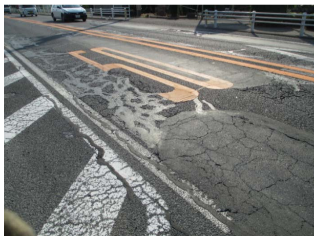
写真 2-1 修繕工事現場の路面状況
