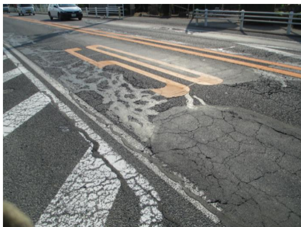
写真 2-1 修繕工事現場の路面状況
