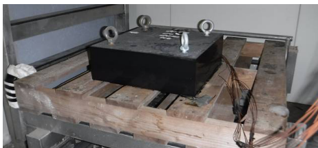
図-4.1 試験施工前のゴム支承の状態（支承温度 -22^{\circ}\text{C} ）
