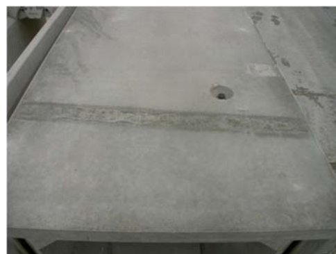
写真-1 台木の設置による変色事例
