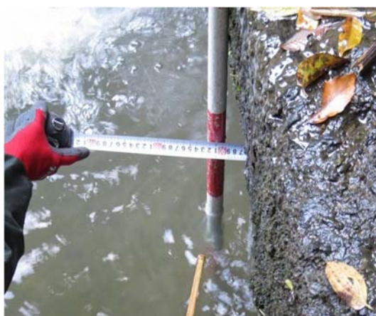
写真-10 底版直下の洗掘の例
