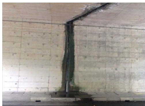
(a) 継手部材の劣化と漏水
