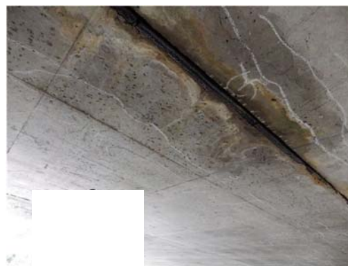
(c) 炭酸カルシウムが浮き出た例
