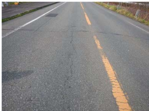
(b) 上部道路縦断方向も含む亀裂
