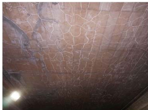
写真-1 亀甲状のひびわれの例
