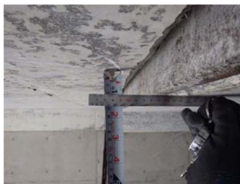
(b) 鉛直方向の段差
