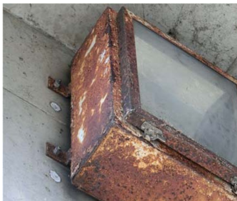
写真-3 照明器具の腐食の例
