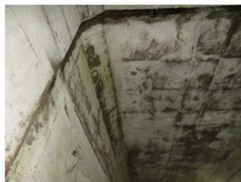
(e) 水分が流入したコンクリートの例
