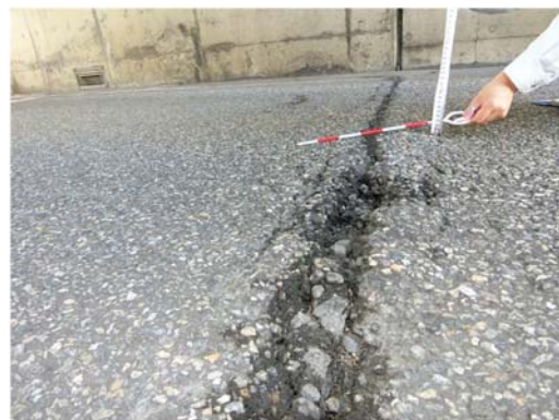
(a) 継手位置に沿った亀裂・段差
