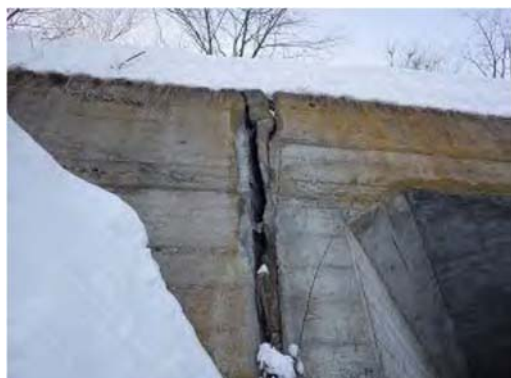
(a) 止水材の劣化・破損および水の流出
