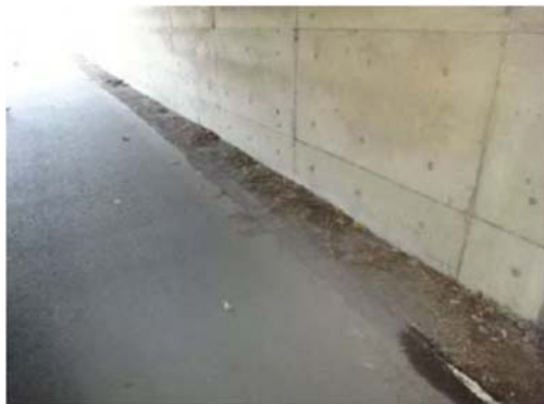
(b) 排水溝の土砂詰まり
