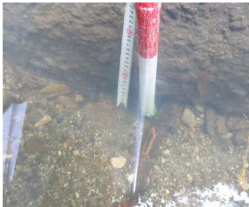
写真-8 底版直下の洗掘による空洞
