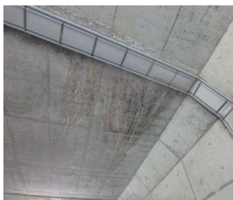
写真-5 導水工からの漏水を契機にした変状の進展の例
