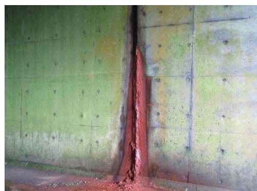
(b) 継手部からの土砂の流入
