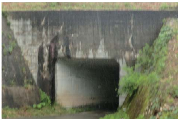
写真-3 ウイング打継不良部からの錆汁
