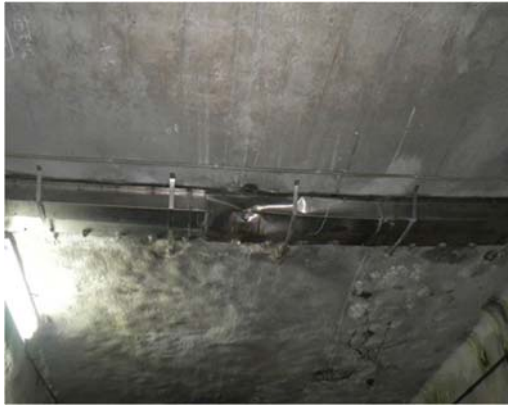
(a) 導水工の破損による漏水
