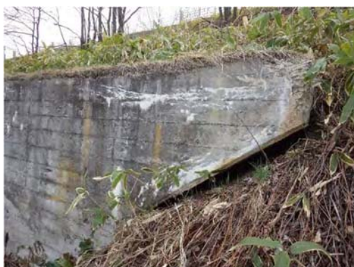
(c) 盛土とウイングの隙間
