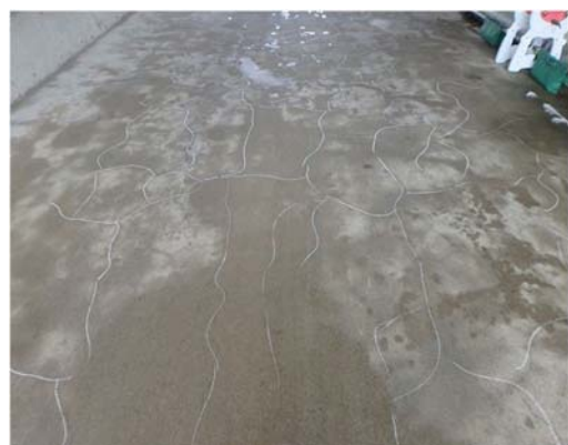
(b) 凍結融解によると考えられる亀裂
