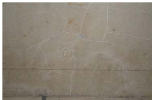
(b) 乾燥収縮によると考えられる不規則なひびわれ 写真-1 頂版のひびわれの例
