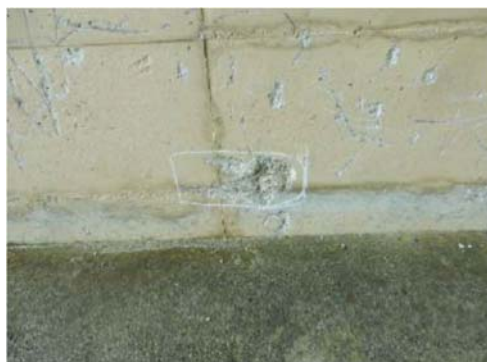
写真-4 コンクリート欠損の例
