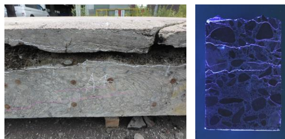
(a) 切断面 (b) 微細ひび割れ 写真-2.2 コンクリートの劣化状況
