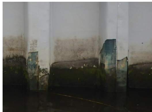
写真-2.6 保護モルタルの剥落状況
