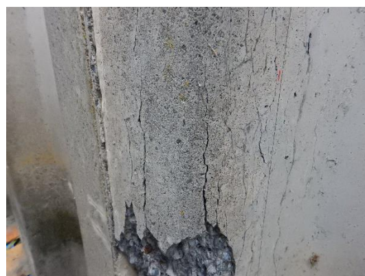
写真-2.3 鉄筋露出部上端のコンクリートひび割れ
