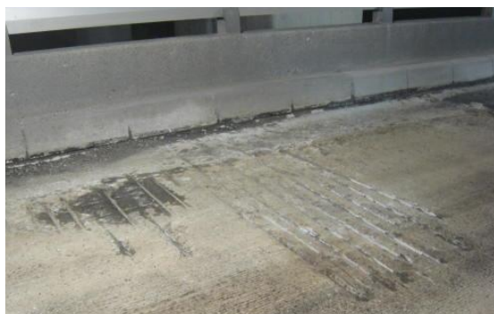
写真-6.1 舗装端部からの水分の浸入によるRC床版の損傷例
