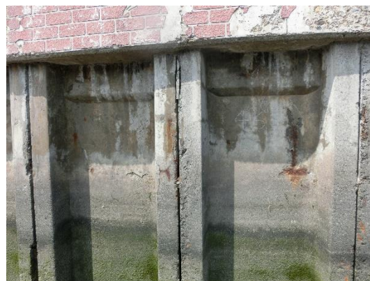
写真-2.5 塩害腐食によるひび割れ
