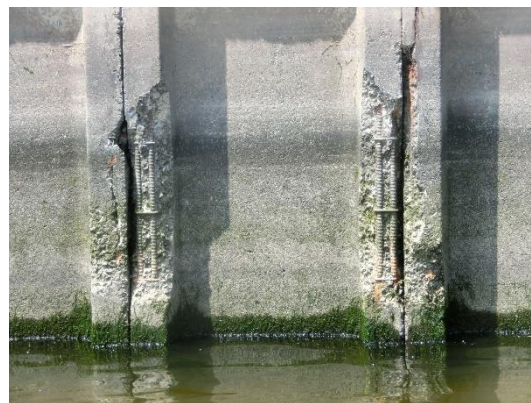
写真-2.2 未補修区間の鉄筋露出状況
