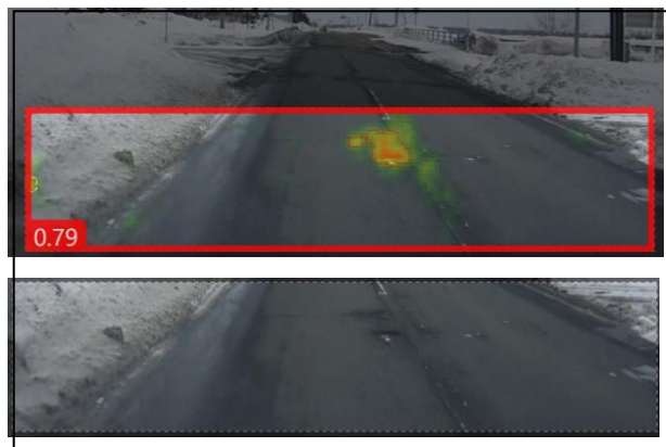
図-2.18 正検出の例(真陽性、ポットホールが検出できている)
