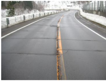
写真-2.1 低温ひび割れ
