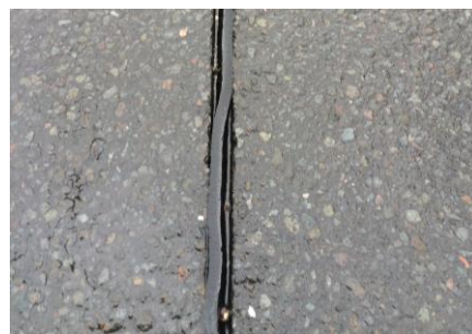
写真-10.1 供用後に発生した目地部の隙間
