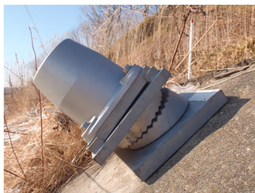
写真-1.1 グラウンドアンカー頭部の変状事例
