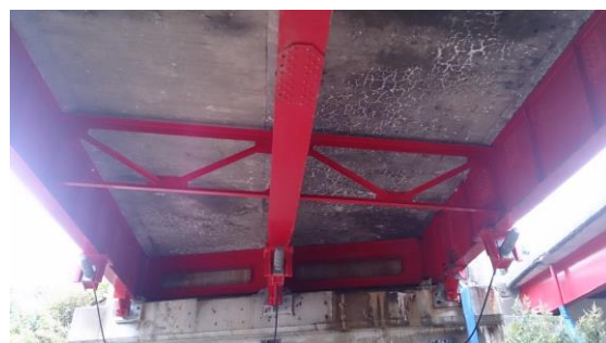
写真-2.1 対象橋梁の床版下面の状況
