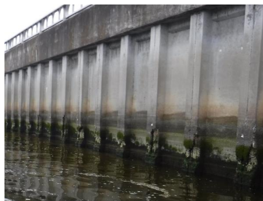
写真-2.1 未補修区間のコンクリート剥離状況
