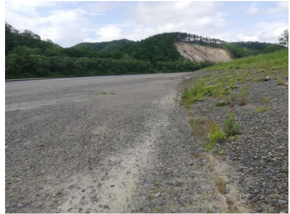
a) 平水掘削後に出水を経験した箇所
