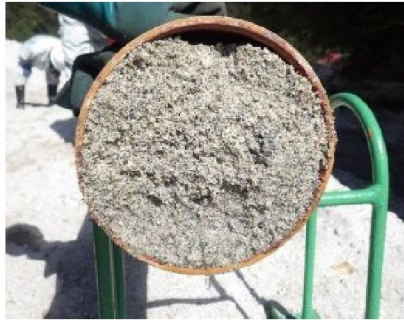
図-28 管閉塞の状況
