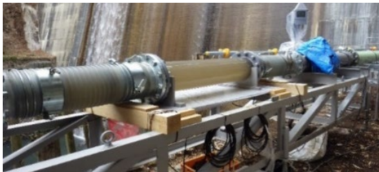
図-53 流量・土砂濃度計測装置据付状況
