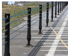
写真-12 既設橋梁用支柱
