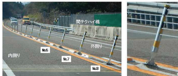
写真-16 傾倒事象発生状況(左: 全景, 右: No.6支柱) 7)
