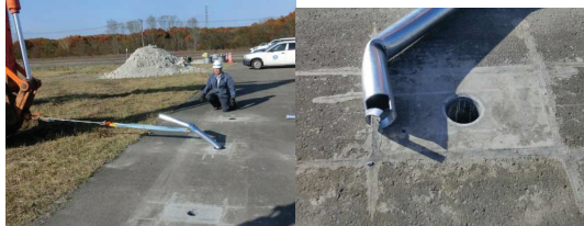
写真-27 引張り試験（左）と試験後の状況（右）
