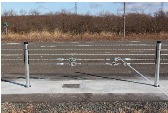
写真-46 緊急ワイヤロープ切断金具の確認試験
