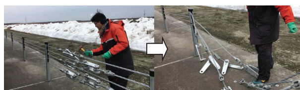
写真-44 緊急開放金具の使用状況
