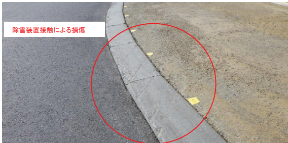
図-25 浜頓別町ラウンドアバウト損傷状況
