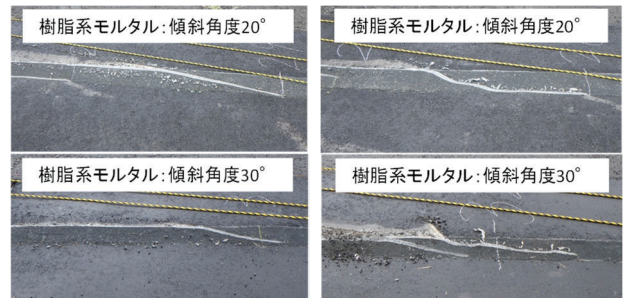
図-62 樹脂系モルタル形状の損傷状況 (左: 除雪グレーダ 右: 除雪ドーザ)
