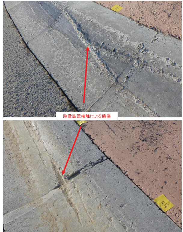
図-27 長井市ラウンドアバウト損傷状況
