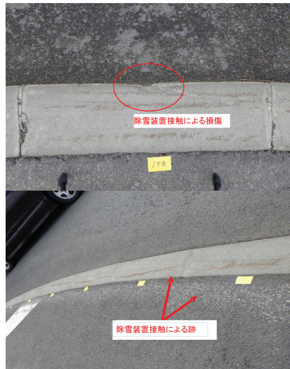
図-24 上ノ国町ラウンドアバウト損傷状況
