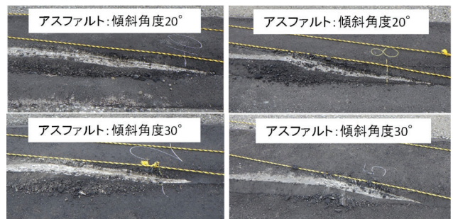
図-61 アスファルト形状の損傷状況 (左: 除雪グレーダ 右: 除雪ドーザ)
