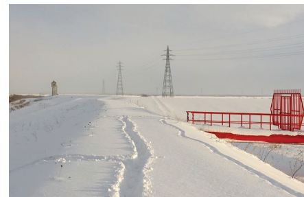
写真-4 東の里排水門に隣接する排水機場管理橋（右側／写真左奥が東の里排水門）管理者が異なる既設の施設で、色彩ガイドラインの方針とは異なる色（10R 5/14）を使用
