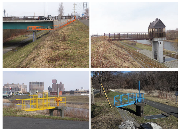
写真-2 管理者や河川・地域等により塗装色が異なる土木施設
