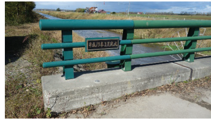
写真-5 指針の推奨色ダークグリーン(5G 2/2)と異なる類似色(5GY 3/4程度)で塗装された高欄。さらに端部の補修部分は色が異なっている
