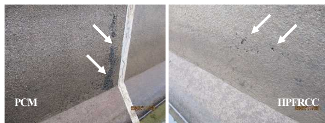
図-47 コンクリートの露出に至った無機系表面被覆材の摩耗
