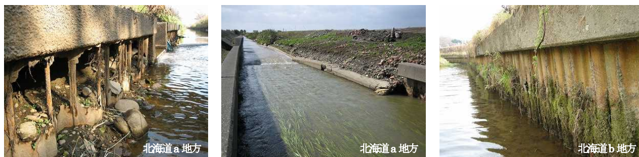
図-10 北海道内における農業用排水路を構成する鋼矢板の腐食
