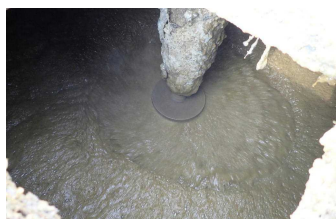
図-3 稼働中の消泡機
