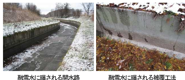
図-33 積雪寒冷地に位置するコンクリート開水路の非灌漑期の状況
