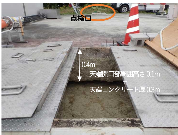
図-33 消泡機が設置されている開口部 （調査対象施設近隣の肥培灌漑施設）
