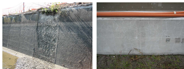
開水路側壁の断面欠損 無機系被覆材のひび割れ
