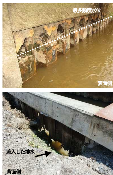
図-12 鋼矢板の腐食の代表的な現況
