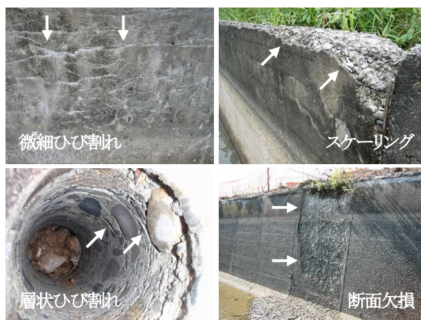
図-19 開水路に発生した凍害劣化による代表的な変状
