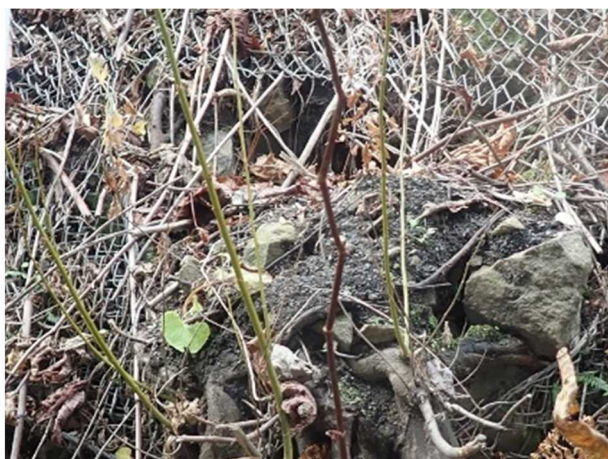
写真-2.1 植生が原因のひし形金網の損傷
