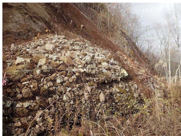
写真-2.2 斜面下部の落石等の堆積
