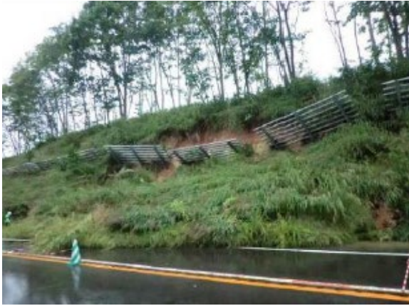
(a) 被災箇所の状況
