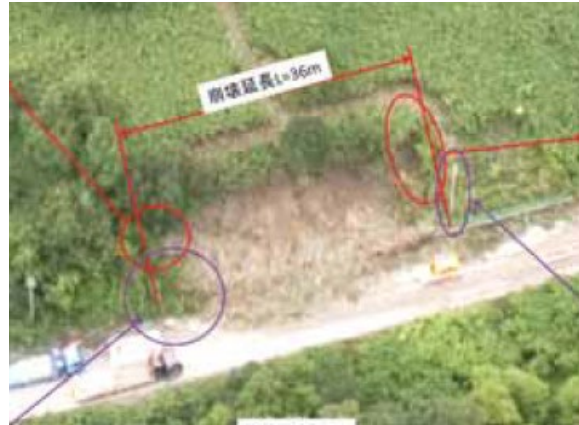
(a) 被災箇所状況 (再掲)
