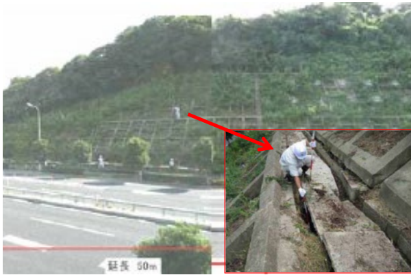
(a) 被災箇所状況
