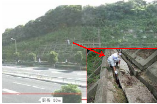
(a) 被災箇所状況 (再掲)
