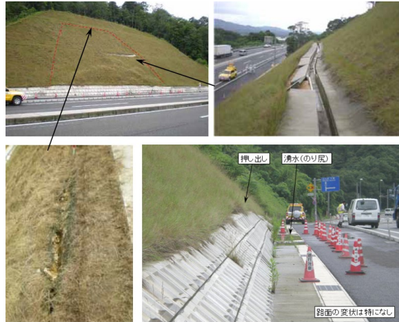
(a) 被災箇所の状況
