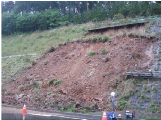
(a) 被災箇所状況
