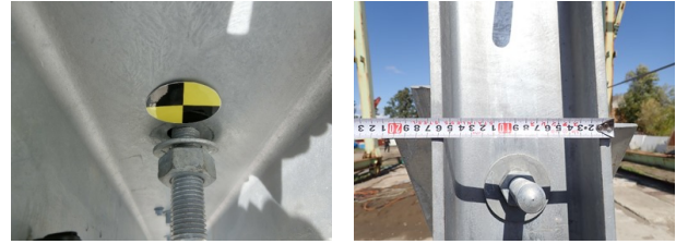
(a) 補強無し (b) 補強有り 写真-2 端末支柱外側の補強鋼板の効果
