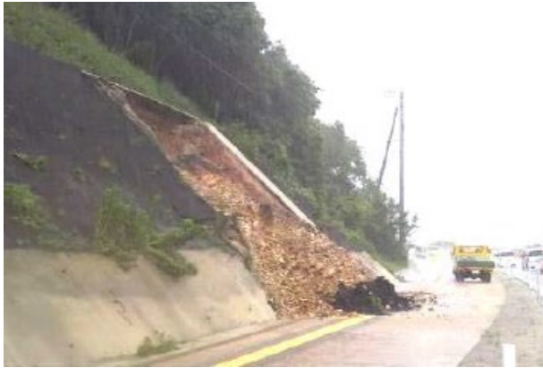
(a) 被災箇所の状況
