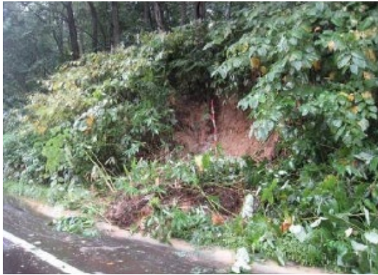
(a) 被災箇所の状況
