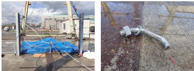
(a) 間隔保持材の車道側への飛散 (b) Uボルトの破断 写真-4 間隔保持材の取付け向きが原因とみられる損傷
