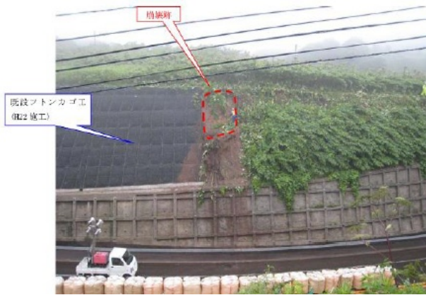
(a) 被災箇所状況
