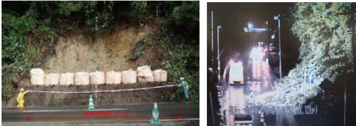
(a) 被災箇所の状況
