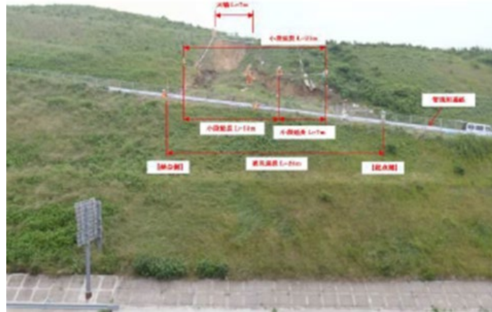
(a) 被災箇所状況
