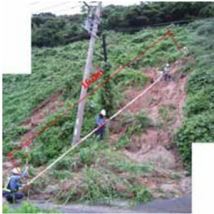
(a) 被災箇所状況
