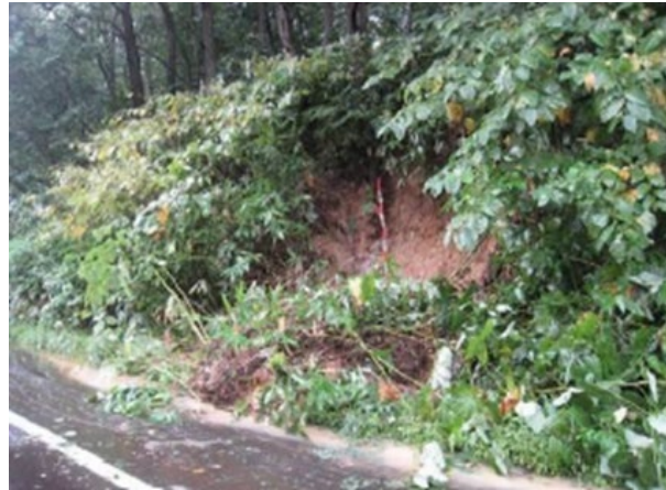
(a) 被災箇所の状況 (再掲)
