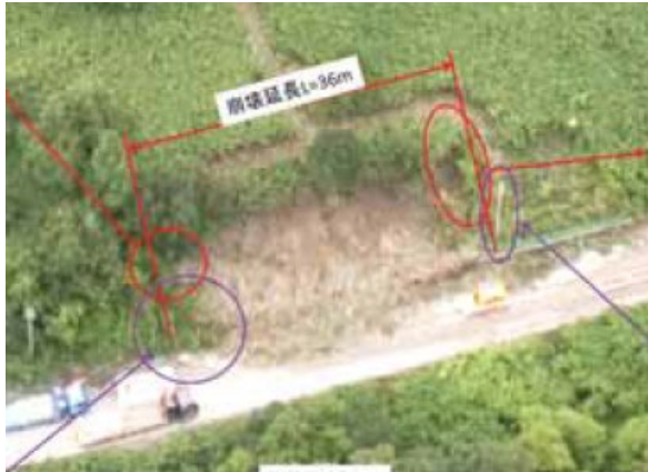
(a) 被災箇所状況
