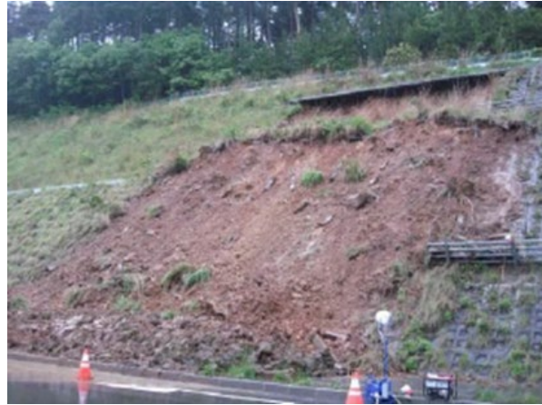
(a) 被災箇所の状況 (再掲)
