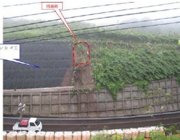
(a) 被災箇所状況 (再掲)
