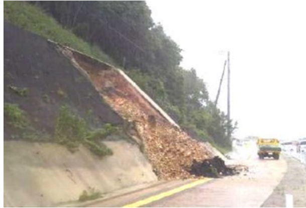
(a) 被災箇所の状況 (再掲)
