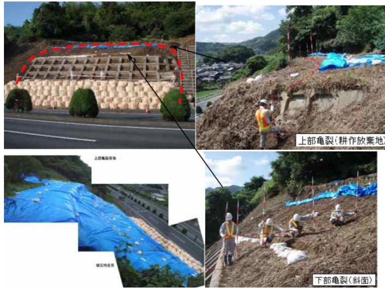
(a) 被災箇所状況
