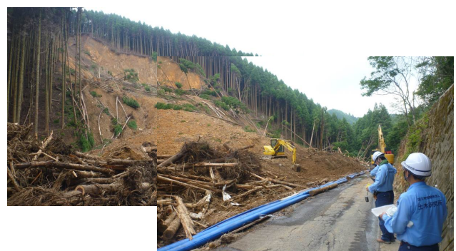
写真-4 厚い風化層の深層崩壊の事例
