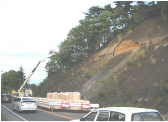
(a) 被災箇所の状況
