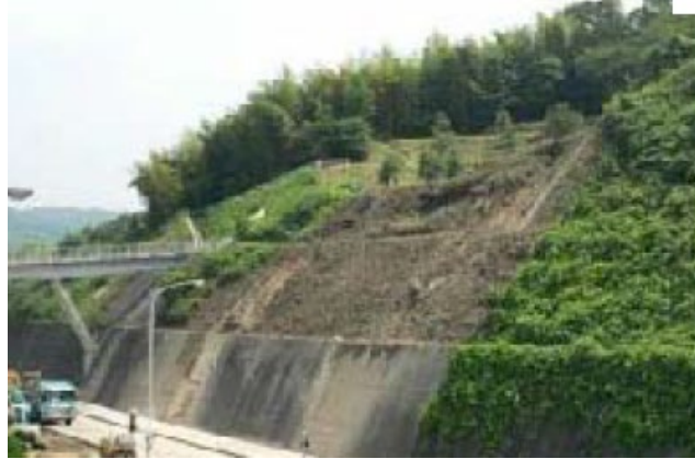
(a) 被災箇所の状況 (再掲)
