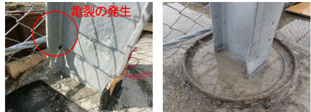
(a) 孔有り (b) 孔無し 写真-3 吊り線用4φ孔による亀裂の誘発
