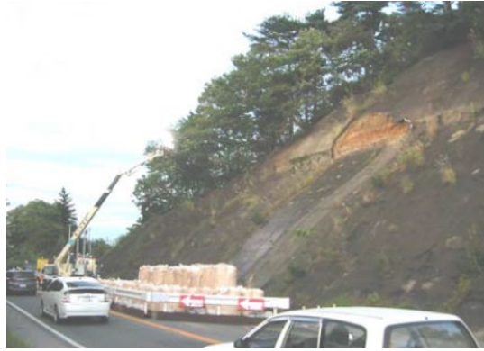
(a) 被災箇所の状況 (再掲)
