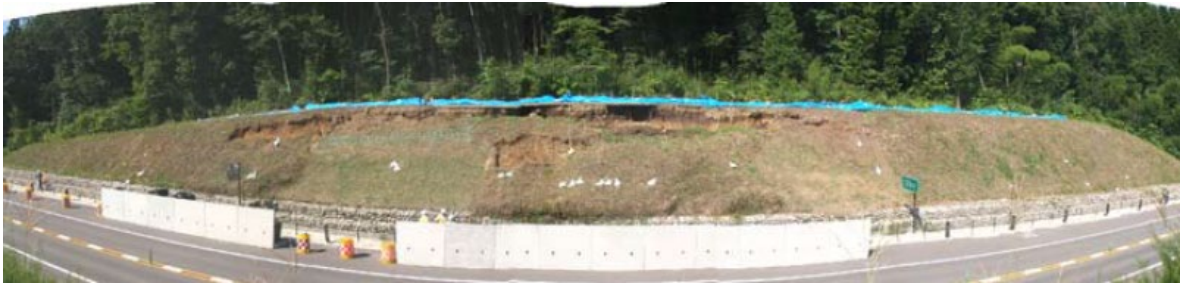
(a) 被災箇所状況
