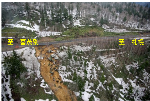
図-1 2012 年の融雪期に発生した国道 230 号中山峠付近の被災の様子
