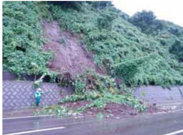
(a) 被災箇所状況 (再掲)
