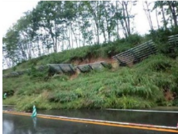
(a) 被災箇所の状況 (再掲)
