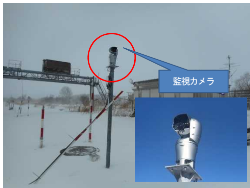
写真-29 監視カメラ設置状況
