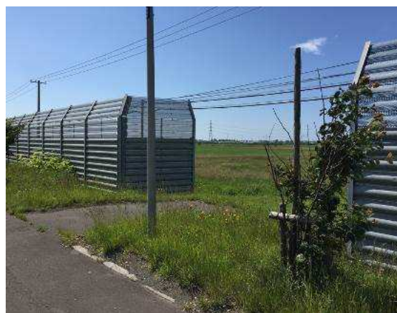
図 34 調査区間に設けられている副防雪柵
