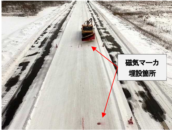
写真-14 自車位置測位実験（直線部）
