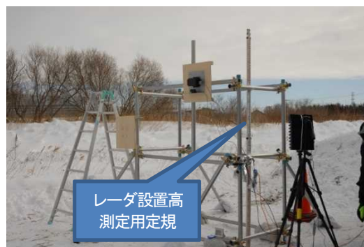
写真-22 ミリ波レーダ設置状況
