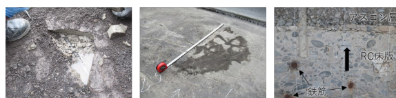
図 1 土砂化の例（左：土砂化、中央：床版の滞水、右：水平亀裂（矢印の箇所）
