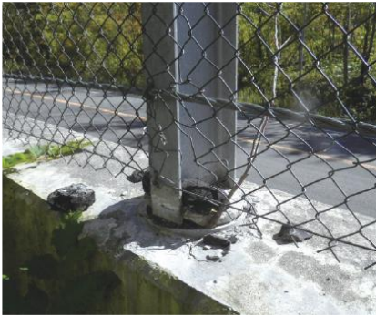
(a) 支柱基部 うき・剥離
