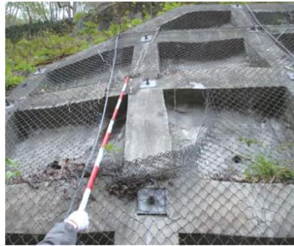
(b) 金網 破損
