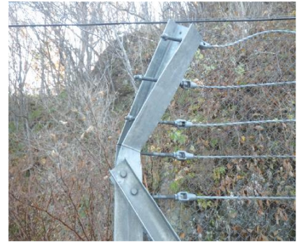
(c) 支柱部 変形
