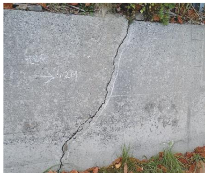
(e) 擁壁部 ひび割れ
