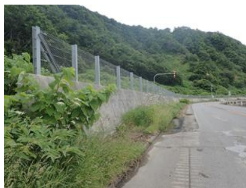
写真-25 従来型落石防護柵の一例
