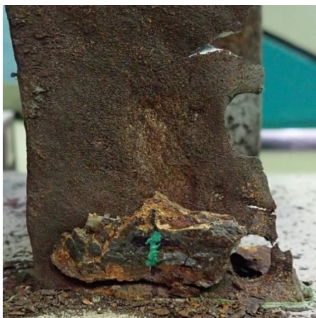
図-25 劣化材6のフランジの腐食と載荷前後の状況
