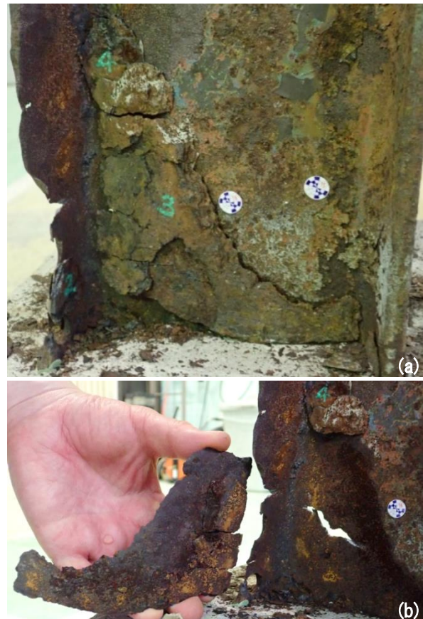
写真-22 剥離した腐食生成物（劣化材6）
