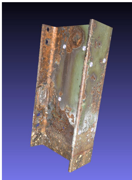
図-15 H型鋼 (劣化材 1) の点群データ
