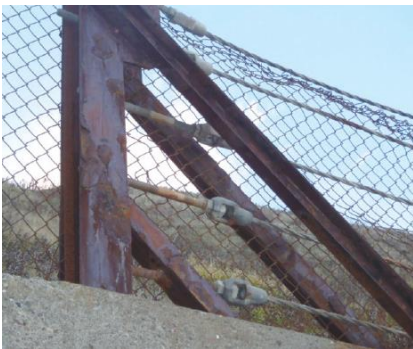
(d) 支柱部・索端金具 腐食
