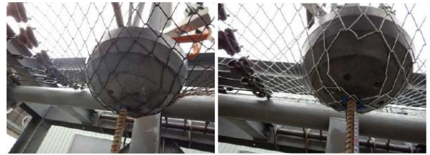
(a) 劣化材 (b) 新品材 写真-11 破網時の状況
