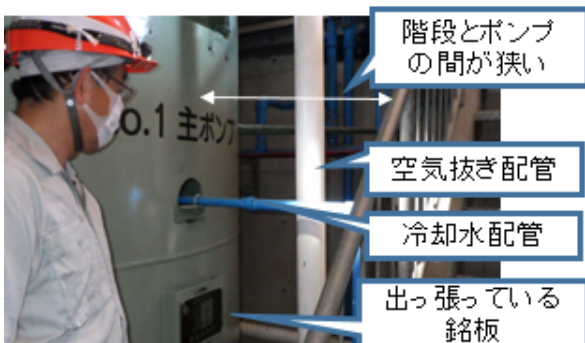
写真-1 室内移動の妨げとなる配管等
