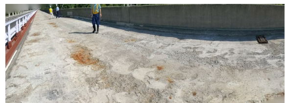
写真-1 床版の土砂化が進行した事例
