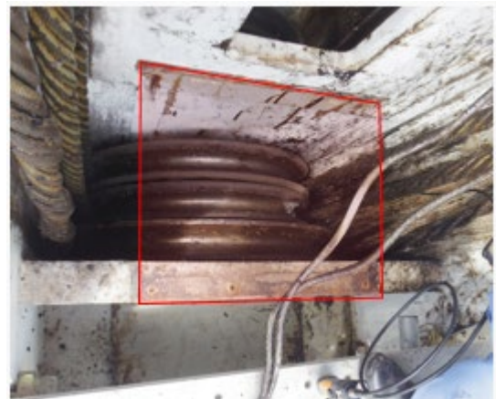
写真-3 シーブボックスのカバー部 (カバーを外した写真に赤枠でカバー部を表示)
