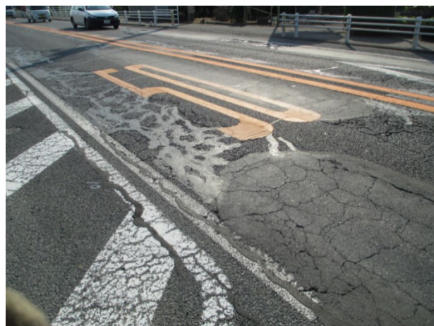
写真-1 修繕工事現場の路面状況
