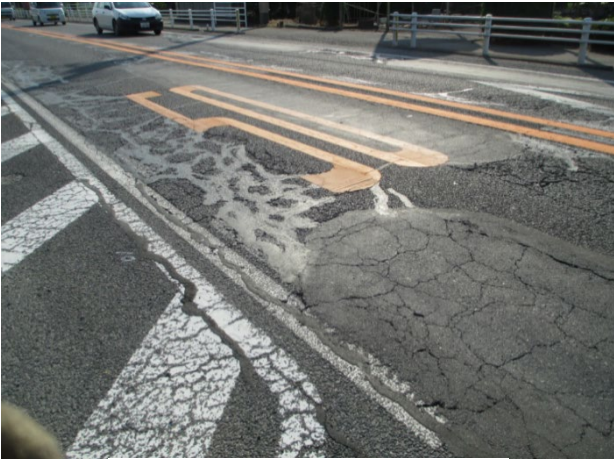
写真-1 修繕工事現場の路面状況
