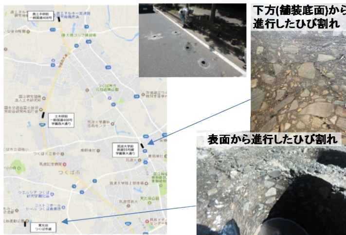
図-6 ひび割れ形態の異なる破損（つくば市内試験舗装区画）
