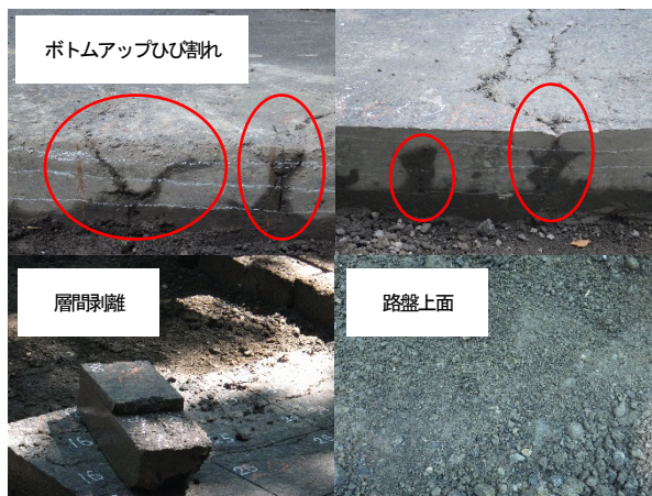
写真-7 ボトムアップひび割れ、層間剥離および下層路盤上面の状況 (OWP)
