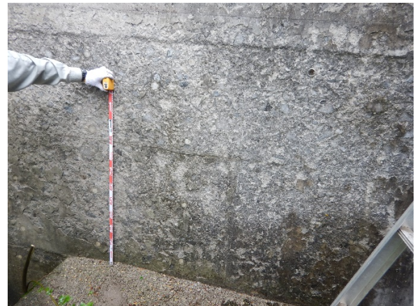
図-2 既設構造物における劣化部
