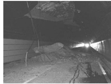
写真-4.1 和南津トンネルの地震被害
