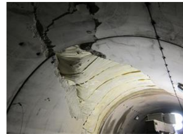
写真-4.2 俵山トンネルの地震被害
