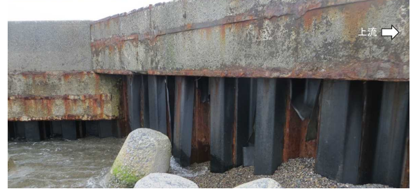
図 - 7 A 導流堤（領域 4）の劣化状況
