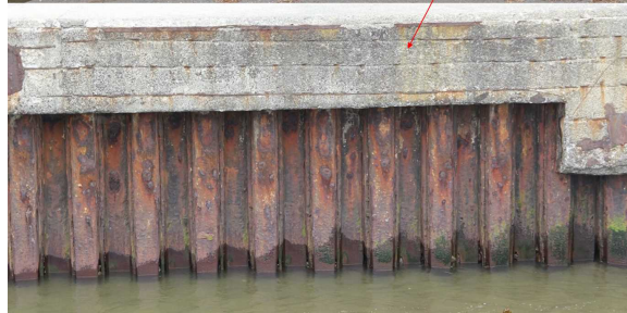
図 - 6 A 導流堤（領域 3）の劣化状況
