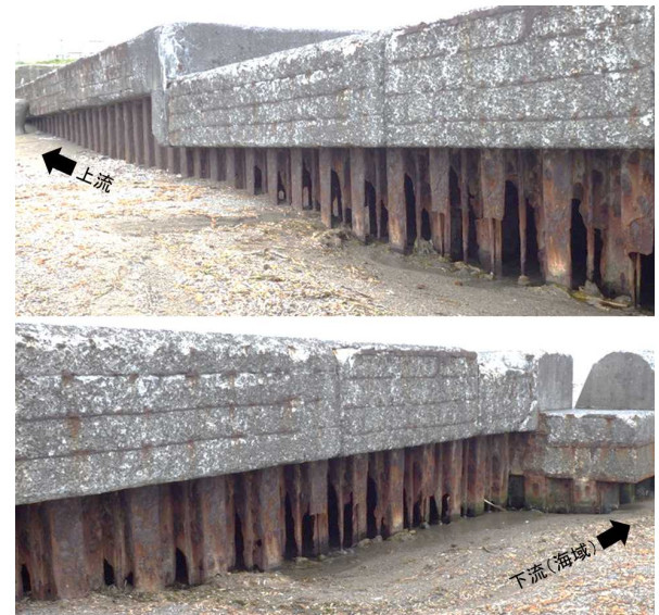
図 - 4 A 導流堤（領域 1）の劣化状況
