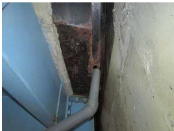
写真-4 2次止水構造導水管破損
