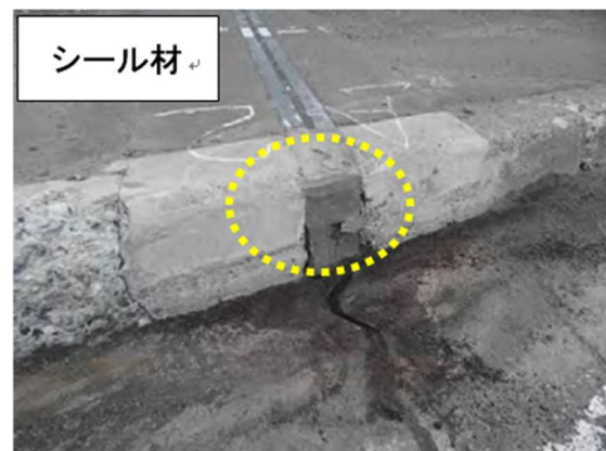
写真-5 境界部損傷事例（プレート、止水ゴム、シール材）
