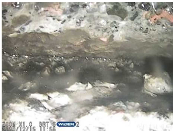
写真-11 打継部付近空隙状況
