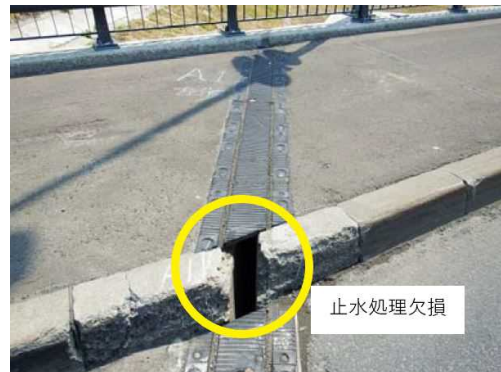
写真-2 歩車道境界部の止水不良
