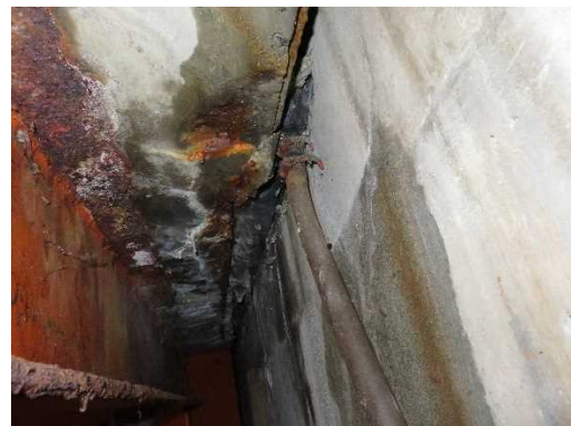
写真-3 橋梁ジョイント近傍からの漏水
