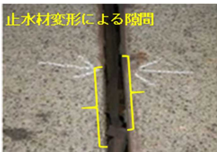
写真-1 止水材の変形事例
