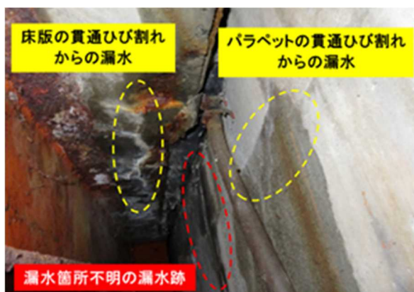
写真-6 遊間部分の漏水事例
