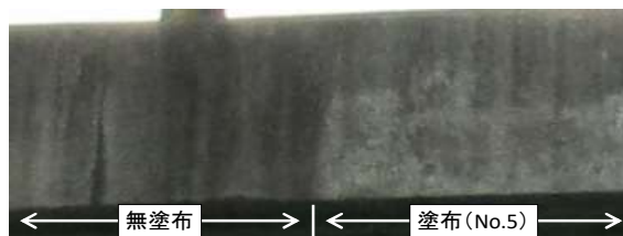
写真-1.7 15年目の外側側面の外観 (No. 5区間と無塗布区間)
