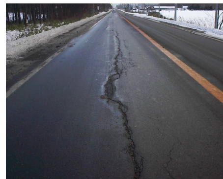
写真-3.2 凍上による舗装のひび割れ
