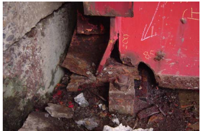
写真-1 鋼橋桁端部の腐食と震災の事例 *) 震災前に、支承付近の鋼桁に、腐食による著しい断面欠損が発生していた。
