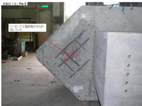
写真-3.4 フーチング上面損傷状況 (Case 2)
