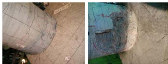
(c) 45度 (d) Case 3 写真-4.1 杭体損傷状況 ( 2d_v )
