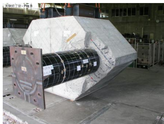
写真-3.3 フーチング下面損傷状況 (Case 2)
