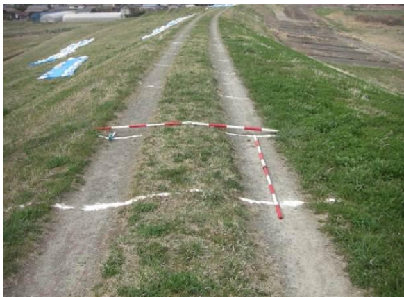
写真-9 対策・無対策区間の境界付近に発生した複数の横断亀裂(手前が対策区間)
