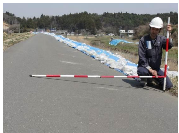
写真-11 天端の傾斜(写真奥がドレーン工設置区間。手前より傾斜が緩い)
