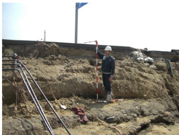
写真-3 対策区間下流の津波越流による浸食の状況
