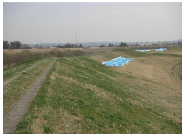
写真-7 対策区間に隣接する堤防の沈下 (写真手前は対策区間)
