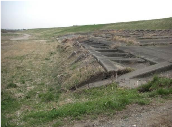
写真-8 無対策区間における高水護岸の隆起
