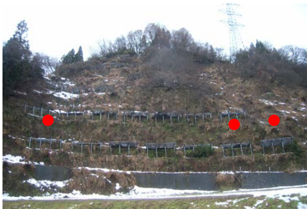
写真-1 横バーをはずした予防柵 （●印はもみがらの充填箇所）
