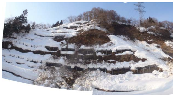
写真-2 巻きだれ状況（十日町市大倉地区） 上から1月19日、2月1日、2月8日
