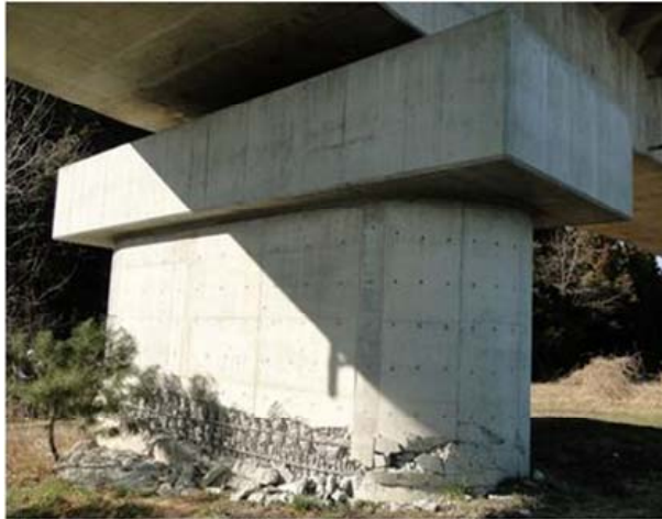
(a) 耐震補強されていなかった橋脚の損傷
