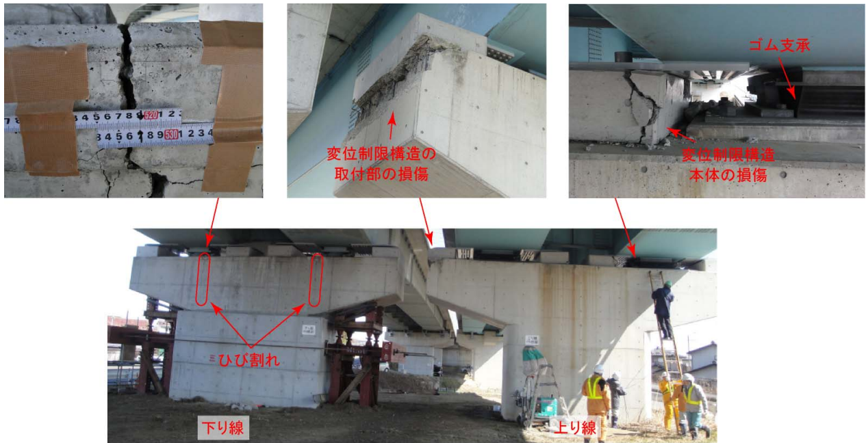
(a) 地震による損傷の状況
