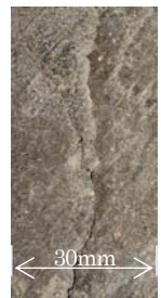
写真-3 床 版下面の 打継目
