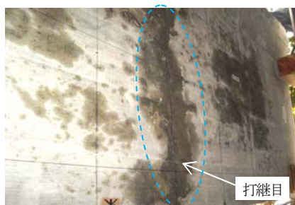
写真-5 As 舗装あり、水張り後1箇月目の床版下面
