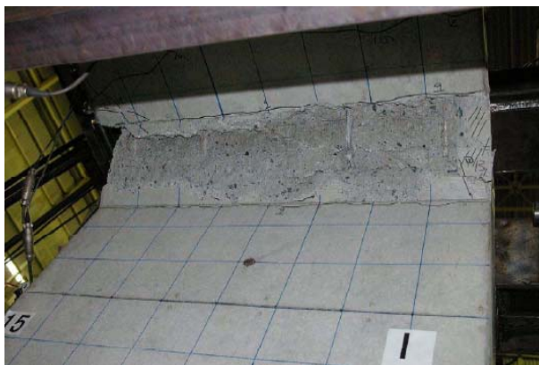
(a) 左側壁上部（ハンチ部）の内面損傷状況
