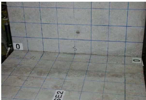
写真-6 CASE2 の損傷写真 (左側壁基部 層間変形角 1/450)
