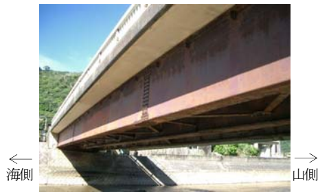
写真-4.1 腐食劣化の生じた橋の全景(2007年7月)
