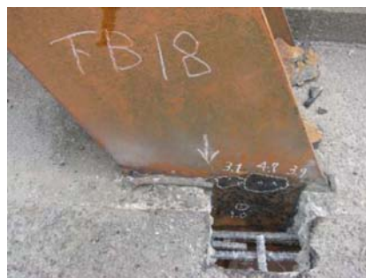
写真-3.1 コンクリート中に埋め込まれた鋼材の腐食欠損の例（コンクリートの一部をはつた状況）
