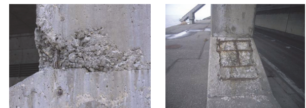
写真-9 覆道柱部の損傷状況 (鉄筋露出)
