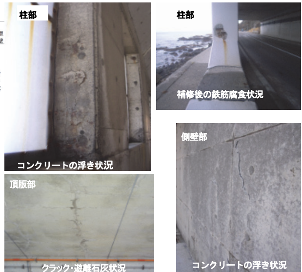
写真-8 日本海側の覆道の損傷状況
