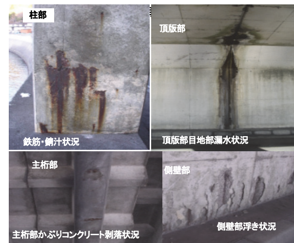
写真-10 覆道柱部の損傷状況 (鉄筋露出)
