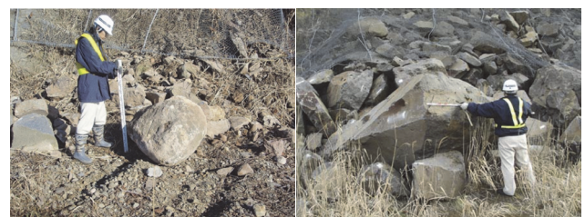
写真-11 覆道上の落石状況
