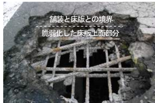
写真-1 脆弱化後の RC 床版の陥没
