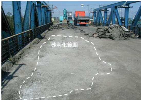
写真-2 RC床版コンクリート上面の損傷箇所
