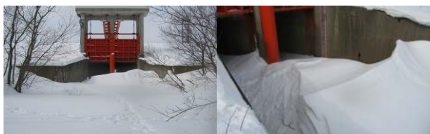
写真-12 スライドゲート冬期状況
