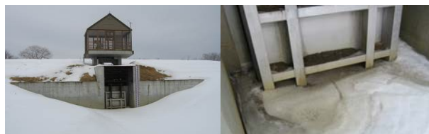
写真-11 オートゲート冬期状況
