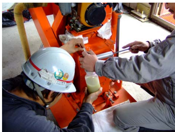
写真-2 潤滑油採油状況（可逆装置）
