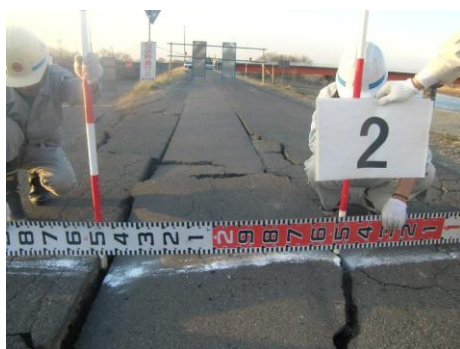
(b) 天端付近の状況 図-3.4 被災状況
