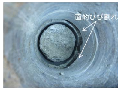
写真-3 コア削孔内の面的ひび割れ (P7-W-5)
