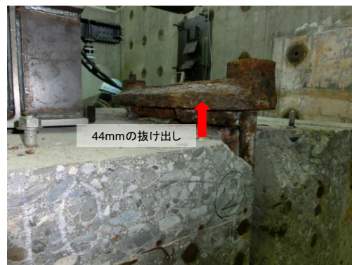
写真-12 固定側支承アンカーボルトの抜け出し状況
