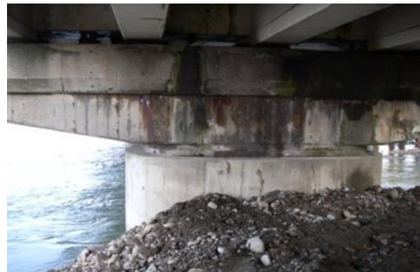
写真-2 RC橋脚の横梁と損傷状況
