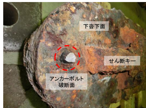
写真-11 可動側支承アンカーボルト破断面
