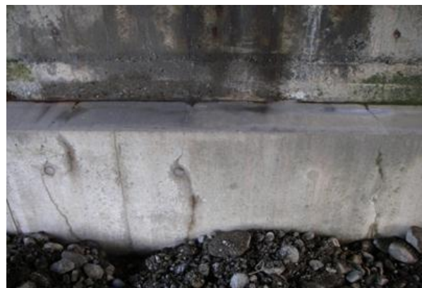
写真-3 RC巻立て補強部のひび割れ
