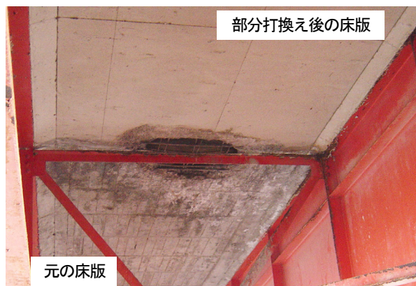
写真-1 部分打換えされた RC 床版の打継目における疲労損傷事例 2)
