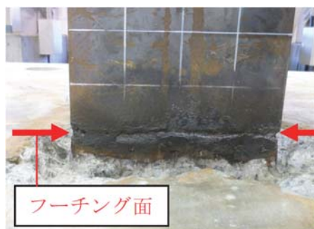
写真-3.1 H形鋼基部の腐食欠損状況
