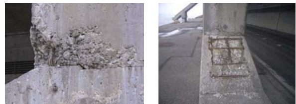
写真-2 柱部の損傷状況（鉄筋露出）
