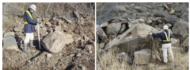
写真-4 ロックシェッド上の落石状況
