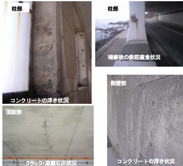
写真-1 ロックシェッドの損傷状況（日本海側）
