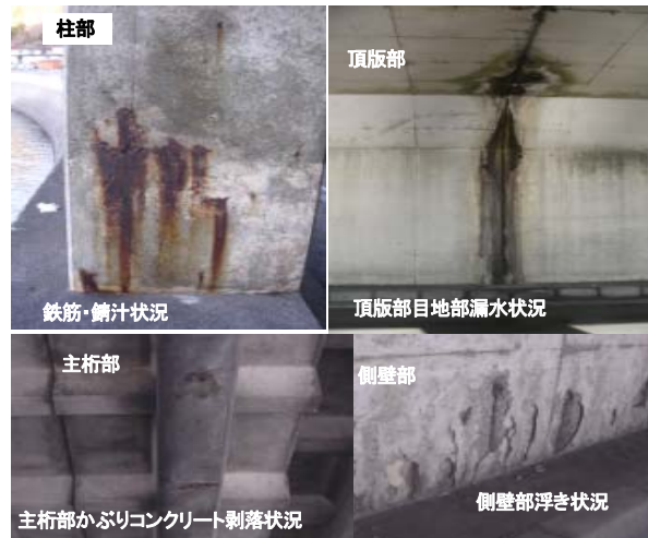
写真-3 ロックシェッドの損傷状況（太平洋側）
