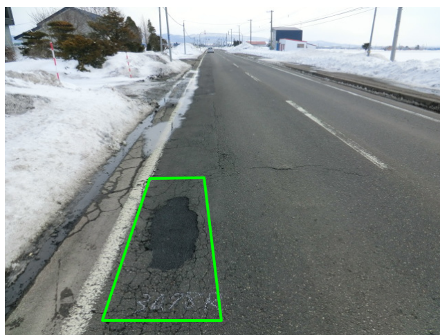
写真-3 写真-2と同一箇所の目視調査時状況 (ポットホールが発生し穴埋めされている)
