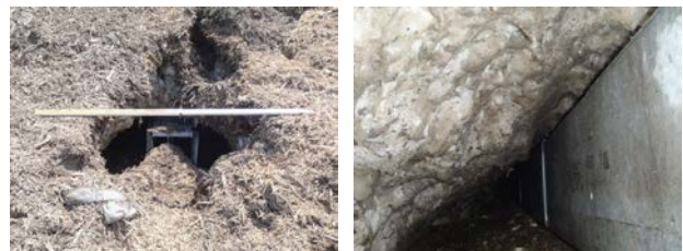
写真-7 全空気式 (5/28) 雪山状況
