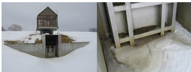
写真-3 オートゲート冬期状況 (道東地区)
