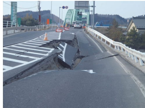
写真-6.1 東北地方太平洋沖地震における国道45号宮城県石巻市鹿又の道路被災
