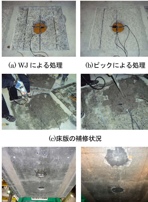
(d)補修前の床版下面状況 (e)補修後の床版下面状況 写真-2 床版陥没部の補修状況
