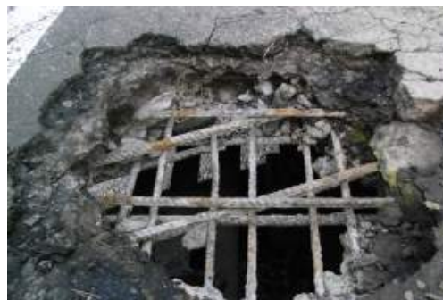
写真-1 陥没が生じた RC 床版
