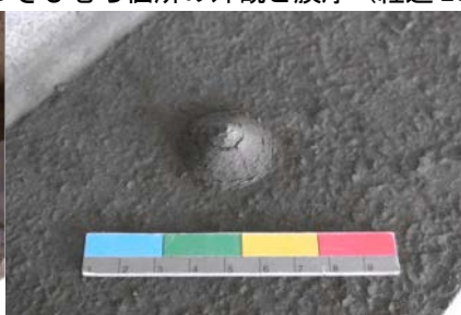
図-8 円錐形のさび (経過 37 年, 離岸 1km)
