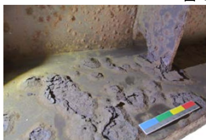
図-7 こぶ状さび (経過 28 年, 離岸 5km)
