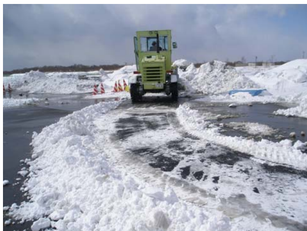
図-13 残雪の発生状況 (除雪グレーダ)
